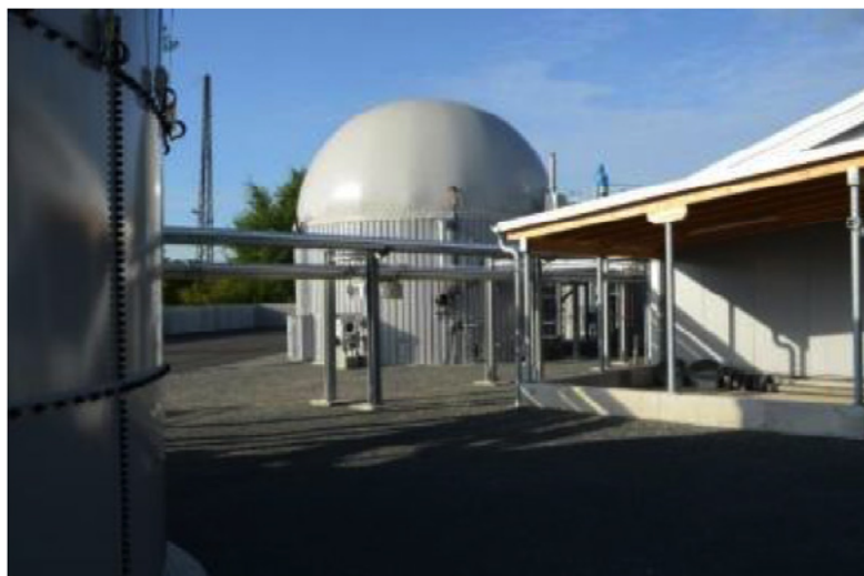
Figura 9: Suprimento de ar para a cúpula de biogás.
