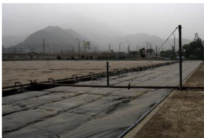
Figura 32: Lagoa anaeróbia coberta ETE, Lima, Peru.
