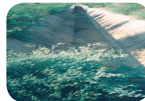
Canal aberto principal de irrigação por gravidade em Ibimirim/PE
