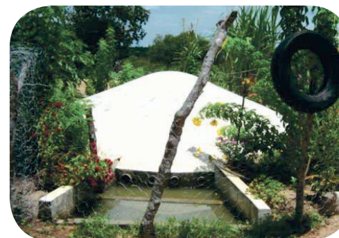
Cisterna de enxurrada, coletando a água que precipita na superfície do terreno
